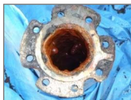
揚湯管内にスケールが付着
