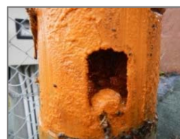
ポンプ吸込み口にスケールが付着
